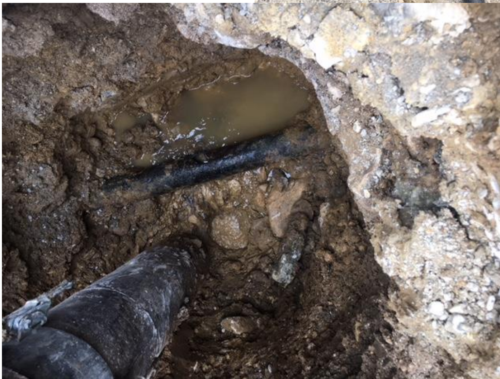
Leck Hälegärtli Endhalt: Leitung stark korrodiert!
