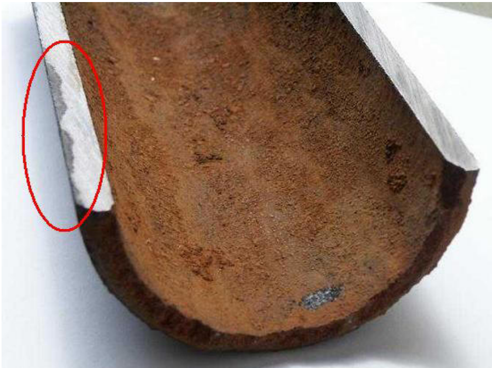
Gussleitung mit Spongiöse Befall
