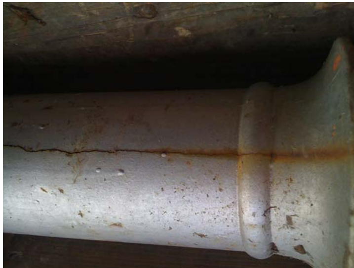
Riss in Hydrantenoberteil über die ganze Länge
